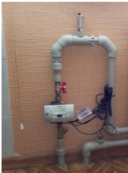
Рис. 2. Фрагмент встановлення квартирного лічильника тепла та повітровідвідника Джерело: розроблено автором.
