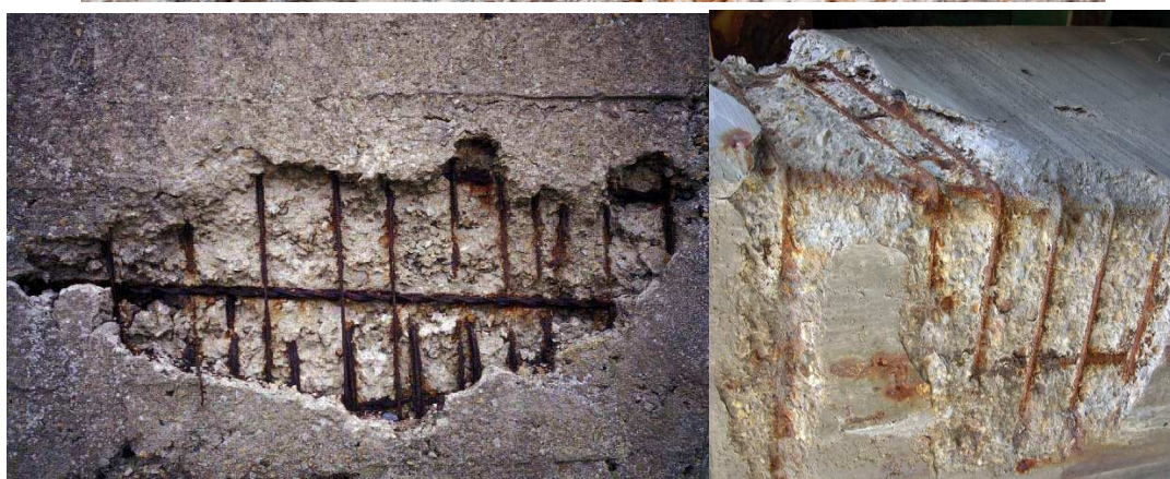
Рис. 4. Руйнування залізобетонних конструкцій внаслідок тривалих корозійних впливів
