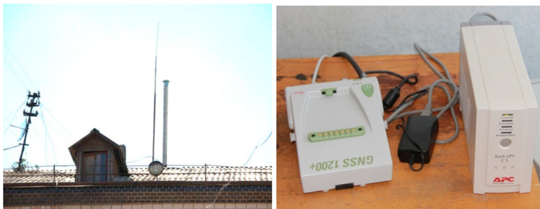
Рис. 3. Обладнання фірми Leica на постійній станції «Чернігів»
