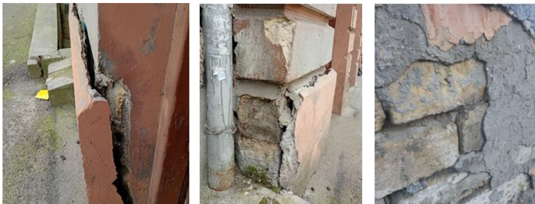
Рис. 3. Приклади відшарування штукатурки від стін з черепашнику
